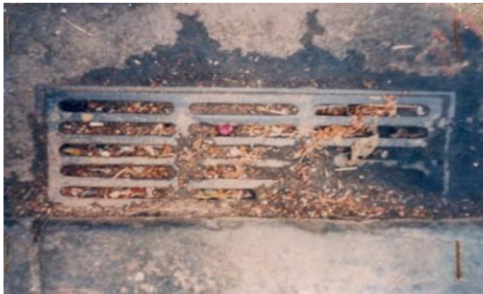
Bueiro entupido no centro de Petrópolis aumenta o risco de inundações
