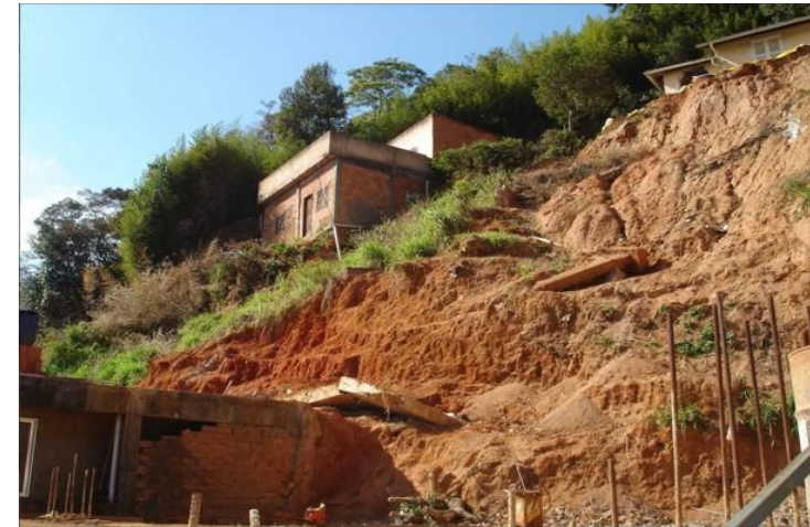
Deficiência de drenagem e corte inadequado (aumento do risco)
